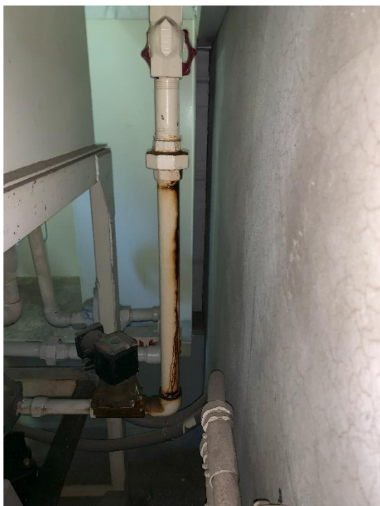
燃料小出し槽下部バルブ 参考写真
